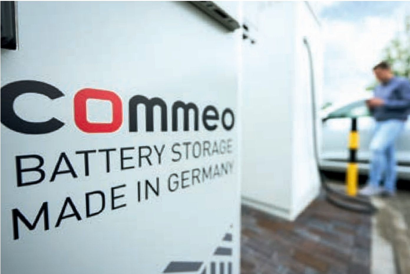
Dream-Team: Die Ladeinfrastruktur besteht aus E-Ladesäule und Batteriesystem im Outdoor-Gehäuse von Rittal (vorne).
