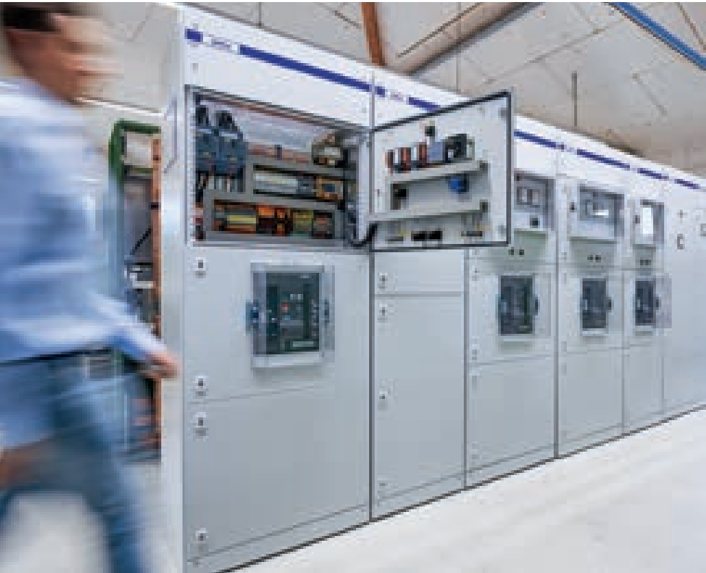
Formunterteilung , Störlichtbogensicherheit B und weitere Anforderungen – für gefeba war die Schaltanlage für thyssenkrupp Steel Europe ein herausforderndes Projekt.
