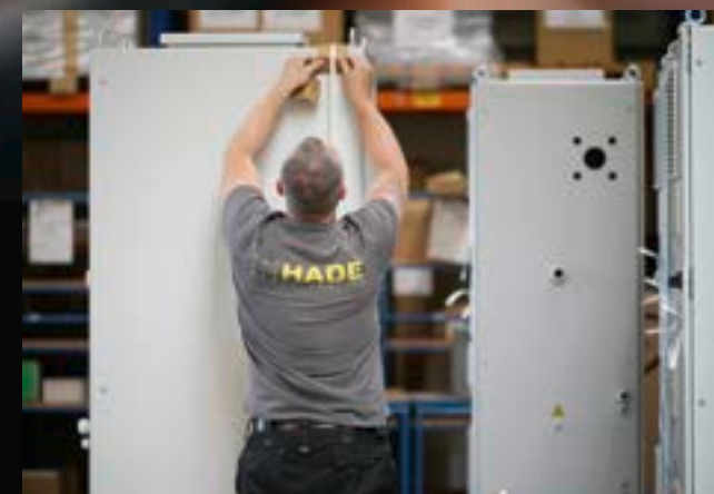
Mit einem durchdachten Prozess und einem hohen Automationsgrad in Engineering und Schaltschrankbau ist Hade Automation gut aufgestellt.
